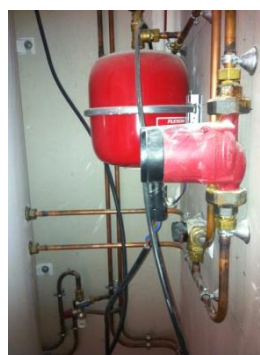
Installation en cuivre reliant le four à pain au chauffe-eau
